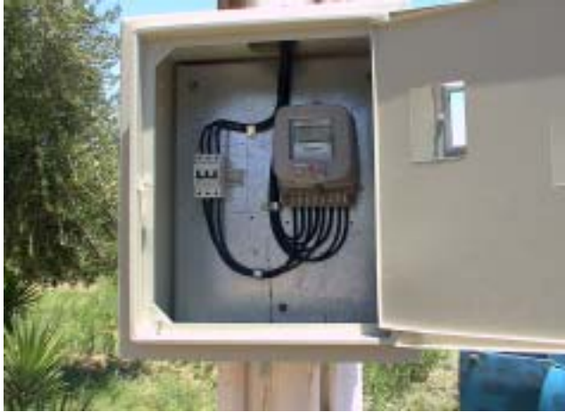
INTERIOR: MEDIDOR / PROTECCIÓN
